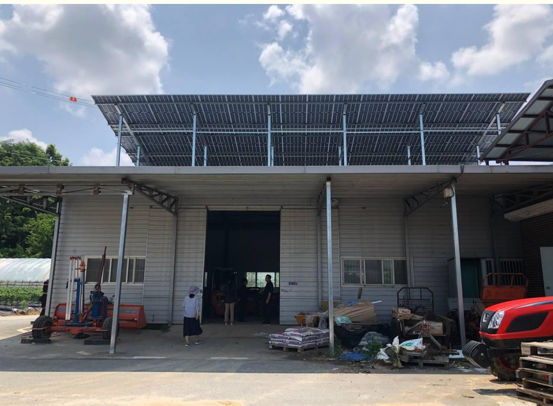
마을 공동 창고에 설치된 태양광 발전 시설
